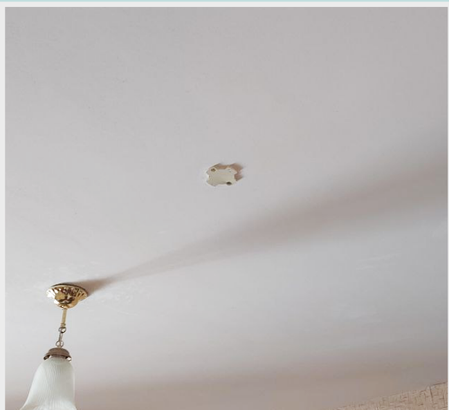
В жилых комнатах демонтированы автономные пожарные извещатели
