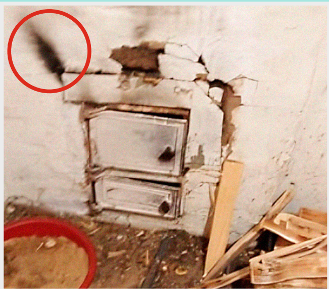
Имеются трещины в печи (место выхода продуктов горения топлива обозначено кругом)
