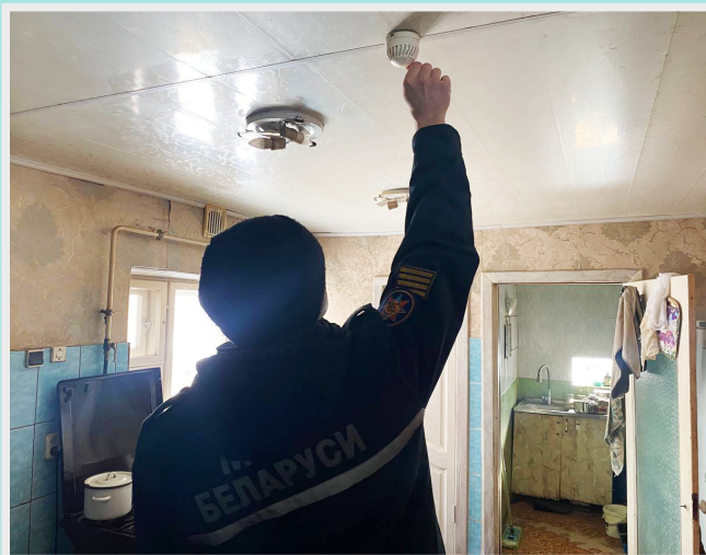
При нажатии на кнопку автономный пожарный извещатель не выдает звуковой сигнал (порекомендуйте заменить элемент питания типа Крона). Напомните о периодической очистке извещателя от пыли
