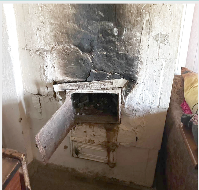
Топочная дверка печи не исправна (не закрывается или не фиксируется в закрытом состоянии)
